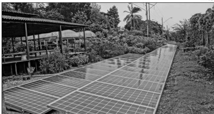
A utilização de energia solar no JBR atende às diretrizes da Agenda Ambiental na Administração Pública
